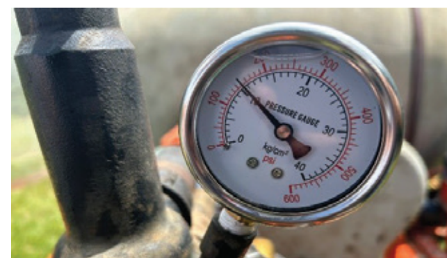
Figura 2. Regulador de pressão e manômetro no turbopulverizador.
